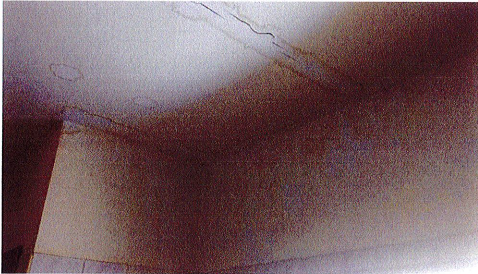
DEGRADARI FINISAJE PRIN INFILTRATII DE APA
