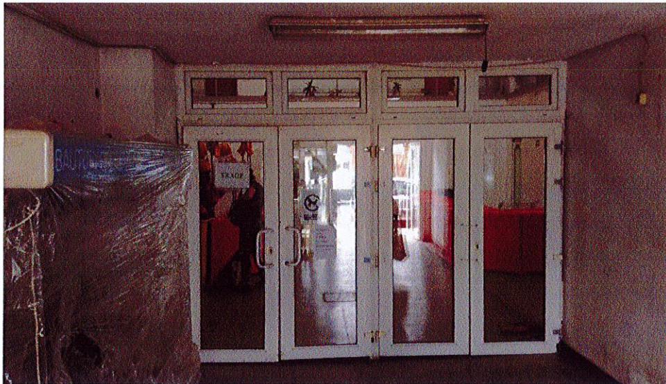
Poza usa acces – se poate observa deteriorarea tamplariei, lipsa manerelor si a barelor antipanica de evacuare.
