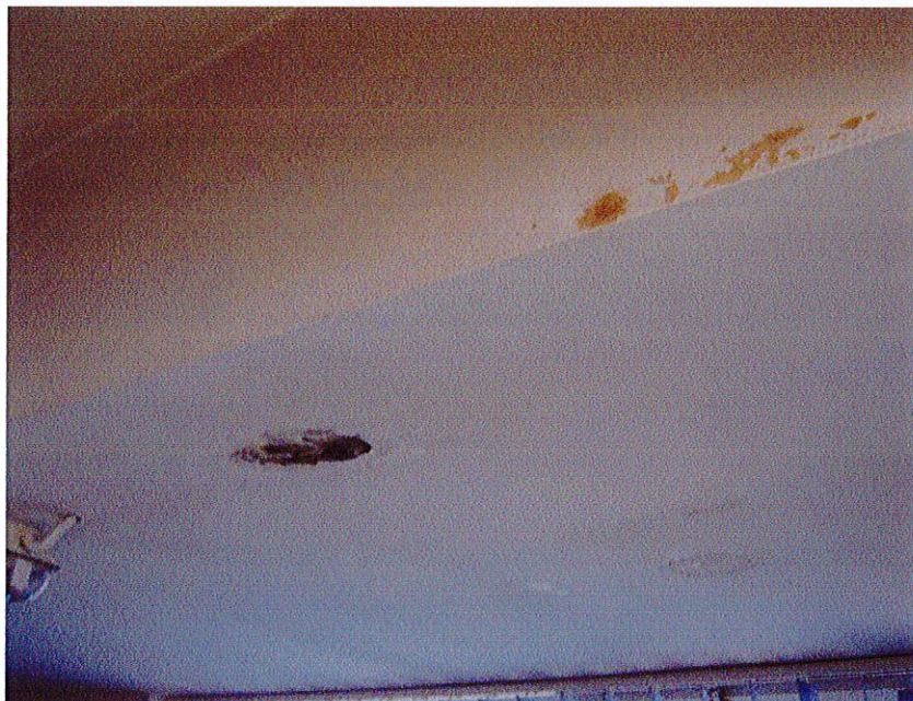
Poza mezanin – se pot observa infiltratiile pe elementele orizontale – tavan suspendat
