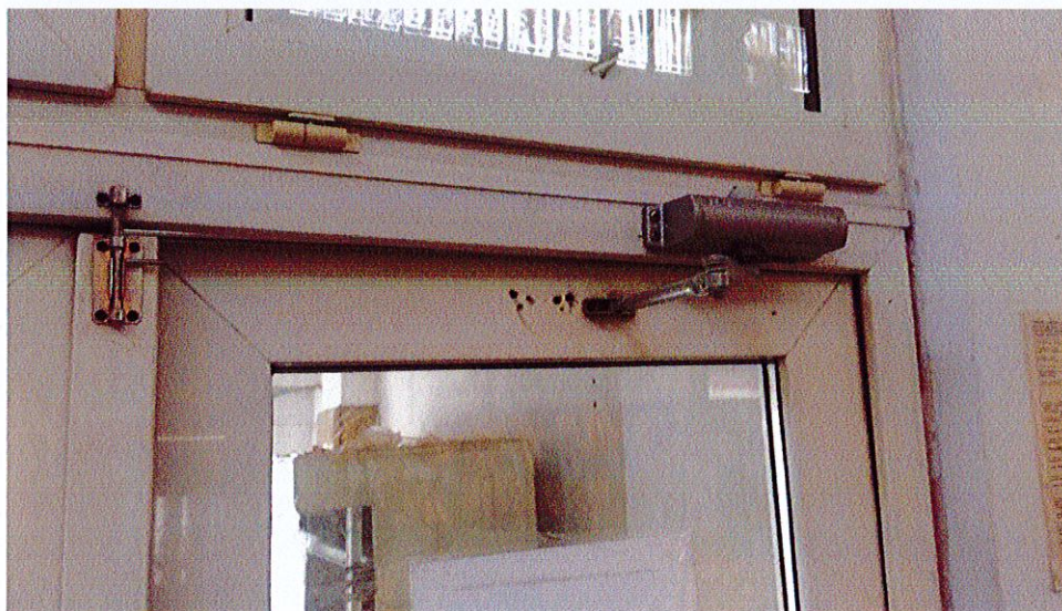
Poza usa acces – se pot observa improvizatiile la sistemul de inchidere, si numeroasele gauri in care a fost prins amortizorul.
