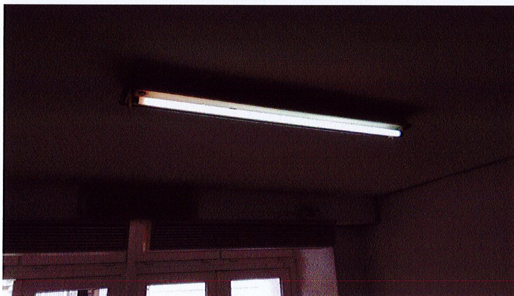
Poza corp iluminat – se poate observa lipsa abajurului de protectie si vechimea corpului de iluminat.
