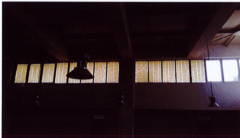
Poza mezanin – detaliu cu exfolierea colantului de pe geamuri
