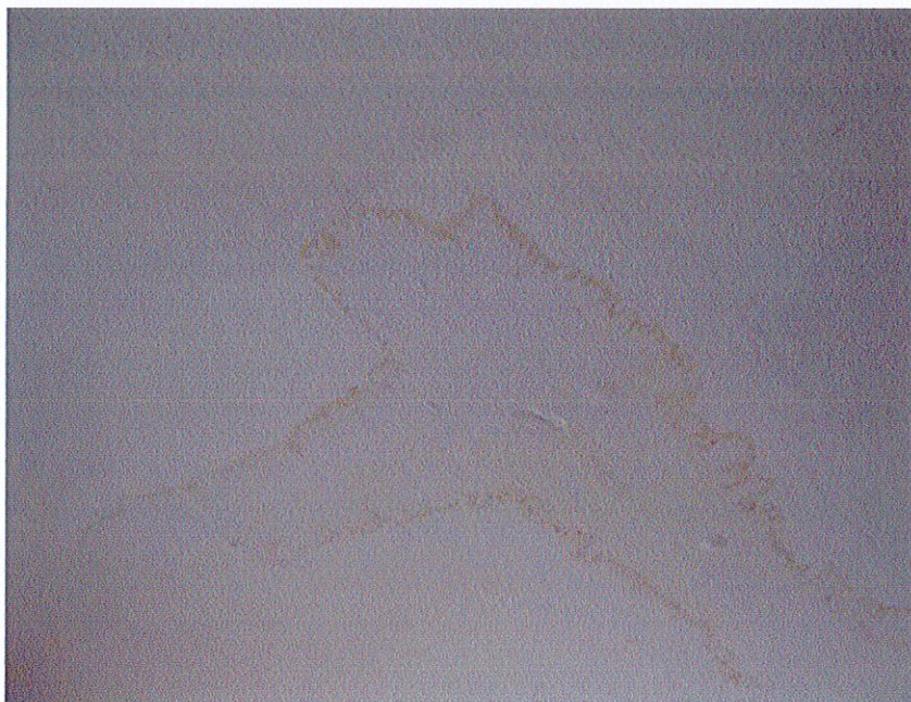
Poza tavan interior – se pot observa urmele de la infiltratii pe pereti
