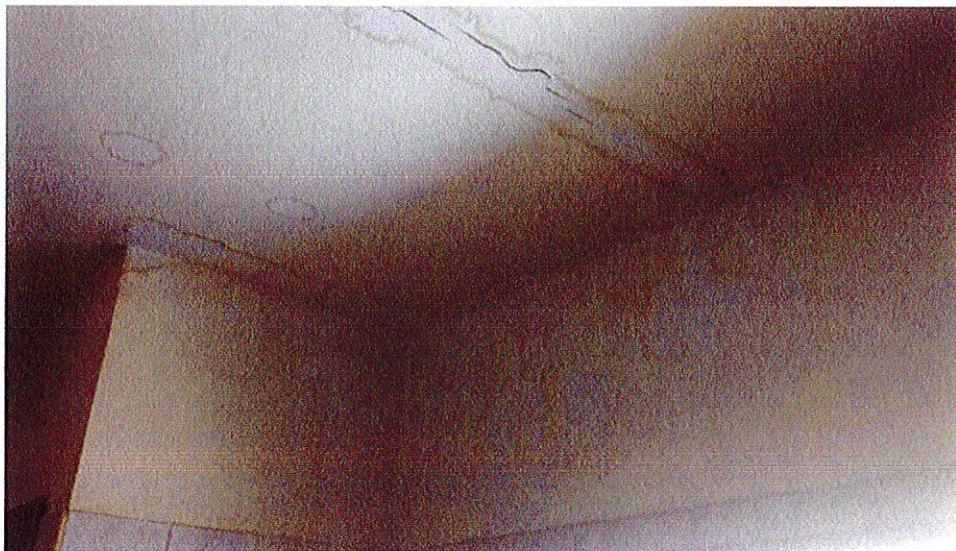
DEGRADARI FINISAJE PRIN INFILTRATII DE APA
