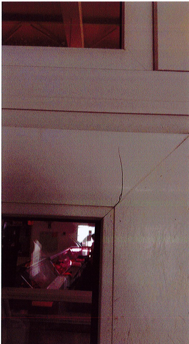
Poza usa acces – se poate observa crapatura de pe profilul de PVC – aceasta se datoreaza montarii unor usi din profile de PVC ce sunt improprii pentru folosirea la usi de acces cu trafic intens.
